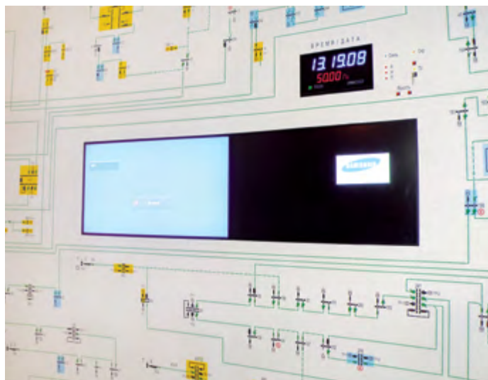
Щит диспетчерский, оборудованный видеозеркалом из двух жидкокристаллических панелей
