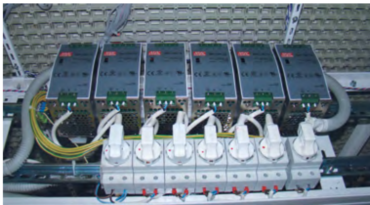
Блоки питания и контроллеры управления, легкодоступны для осмотра
